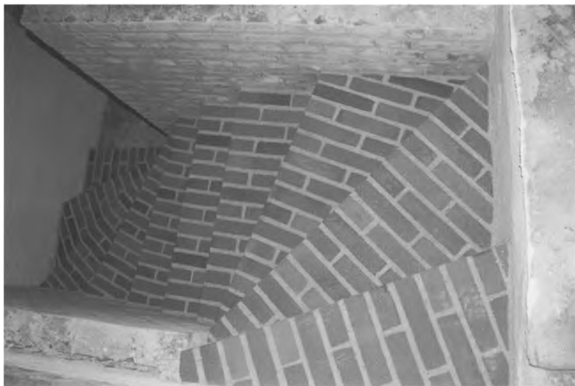
Den nye kvartløbstrappe fra den tidligere fængselscelle for kvinder, det såkaldte »Jomfrubur« til loftsetagen over portbygningen i Tønder Museum, fotograferet, da den var næsten færdig.
