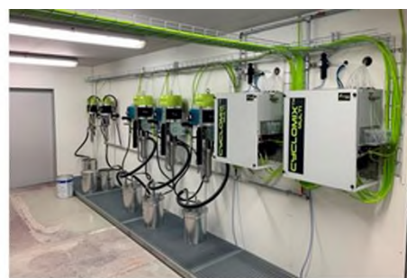
Pumper til travers lakanlæg
