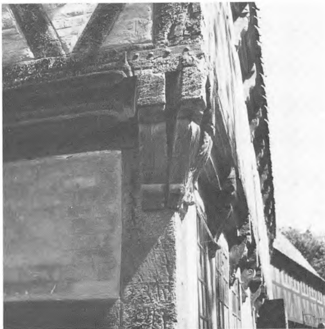
Aalborggården. Mansardpakhuset. Hjørnekonstruktion (efters flytningen til »Den gamle By«, hvor huset ligger adskilt fra gardens øvrige bygninger) med gavlstikbjælker i højde med det normale bjælkelag. En diagonal stikbjælke støttes af en speciel hjørnekægt. Forf. fot.
