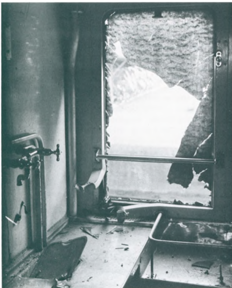
Ituskudt køkken i en af vognene fra tog 339. Det overmalede vindue er knust og inventaret ødelagt. Et par måneder i forvejen blev samme tog også beskudt, denne gang ved Handbjerg, men der skete kun skader på lokomotivet, og ingen mennesker blev ramt. (Centralværkstedet, Århus)
