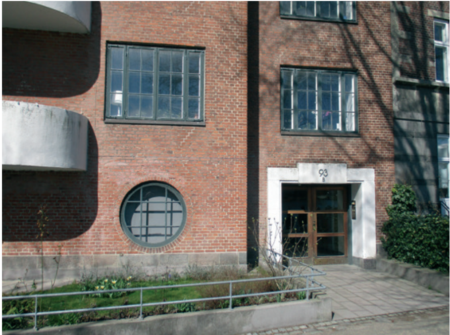
Hovedindgang til Sortedam Dossering 93 B med indramning af travertin og husnummer uden seriffer, "fødder". Fløj døren er af teaktræ. Indhegning af plæne og beplantning med cementkant og jernrækværk er af nyere dato. TE foto 2021.
