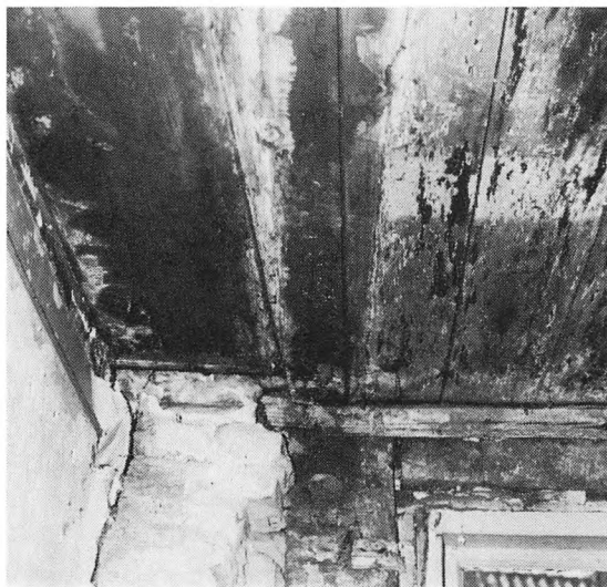
Spor i loftet efter den oprindelige placering af skillevæggen mellem dielen og boden i husets nordvestlige hjørne.
