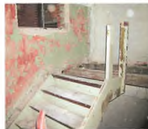
Den øverste del af trappeopgangen i bygning B. Da gulvbrædderne og de underliggende lofibrædder var fjernet fra det øverste repos, kunne de skjulte bjælker registreres.
