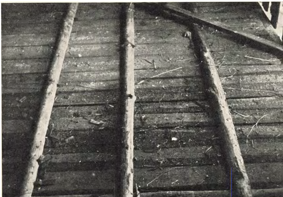
Fig. 102. Et Bræddeloft, som er stabiliseret med Granudskør. Ved et Søm i hvert Brædt trækkes Brædderne op til disse Udkør, der saaledes hjælper til at bære det 5—8 cm tykke Lerlag. (Foreningen til Brandbeskyttelse af Dyr.)
