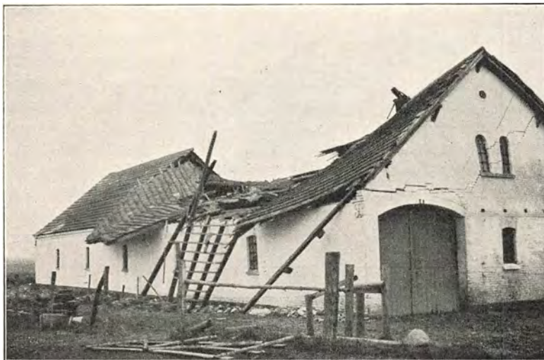
Fig. 75. Tagkonstruktion ødelagt af Fugtighed fra daarligt ventileret Stald.
