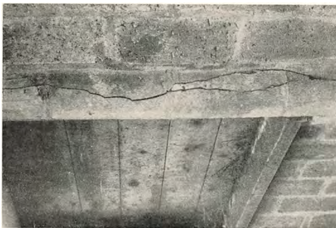
Fig. 72. Bjælkedæksten sprængt af Rustdannelse ved forkert Indmuring.
