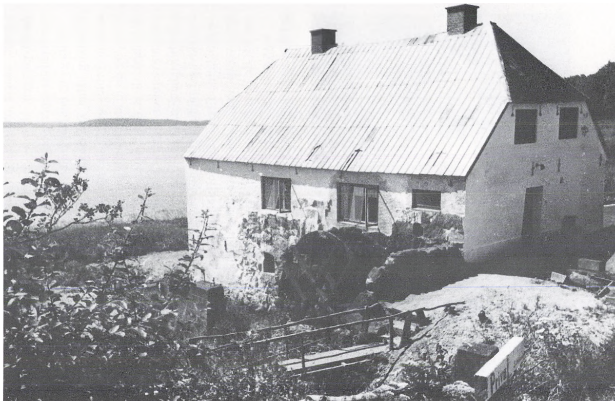
Møllebygningen efter dæmningen var sprængt. En midlertidig bro er lavet over hullet.
