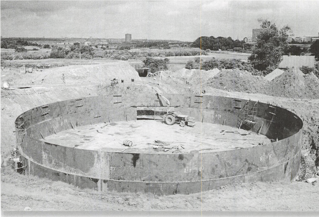
Ifølge Rittas far skulle området anvendes til olietanke til DSB, efter ejendommen blev solgt i 1946. Her ses en olietank under konstruktion.
