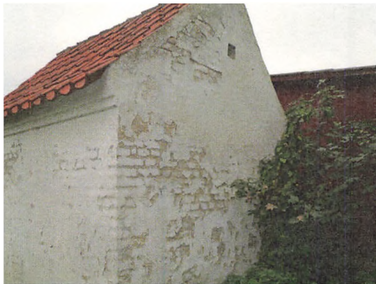
Bagsiden af sprøjtehuset hvor murenes dårlig forfatning ses. Foto: Frede Aagaard Frandsen
