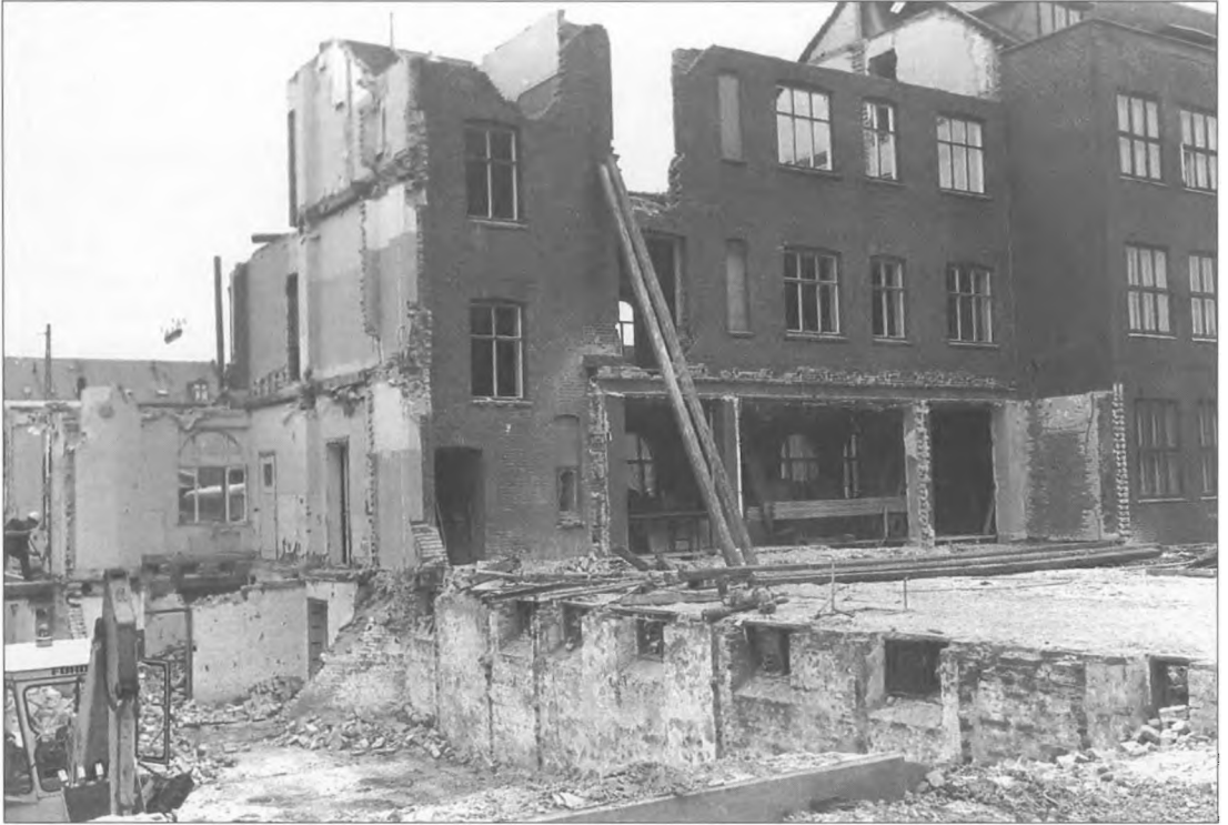
Esbjerg Kommunes gamle administrationsbygning på hjørnet af Danmarks/Torvegade under nedrivningen d. 18. oktober 1971. Foto: Knud Rasmussen. (Esbjerg Byhistoriske Arkiv. B 4.797)
