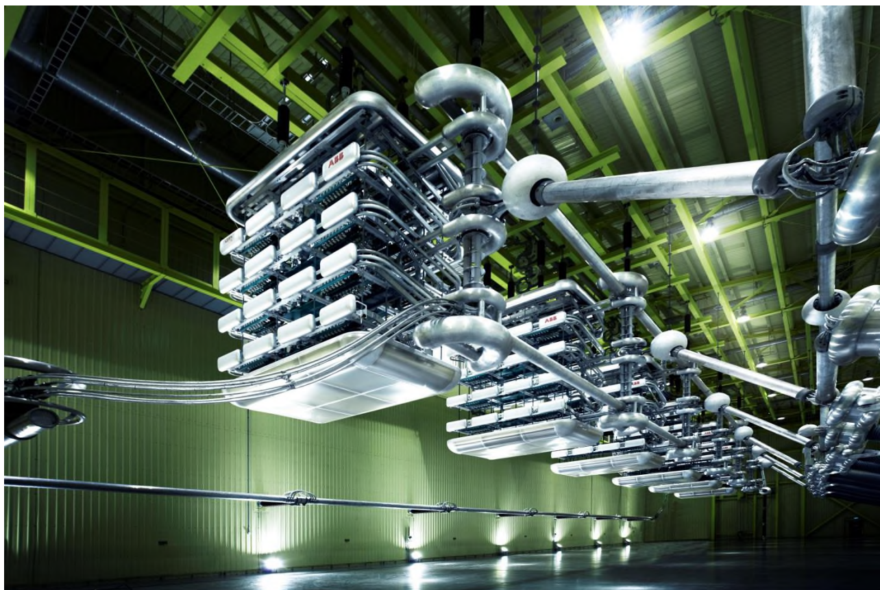
Hal med tyristorer i en transformatorstation for omdannelse af højspændt vekselstrøm til jævnstrøm. Kilde: Wikimedia Commons.
