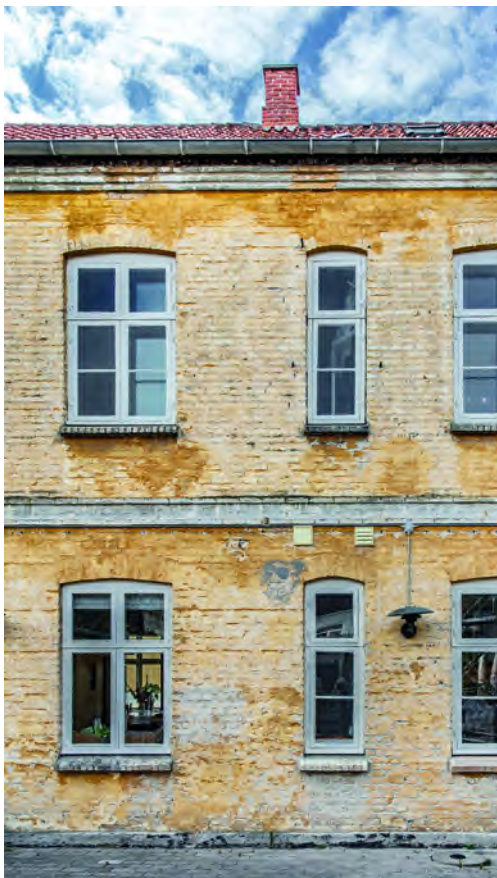
Et bevaringsværdigt byhus i Skælskør (SAVE 3) får rensset murværket for gammelt puds, kalkflager og porøse fuger. Bagefter skal fugerne fyldes med ny kalkmørtel – en skrabeuge – og murværket skal pudses og kalkes igen.
