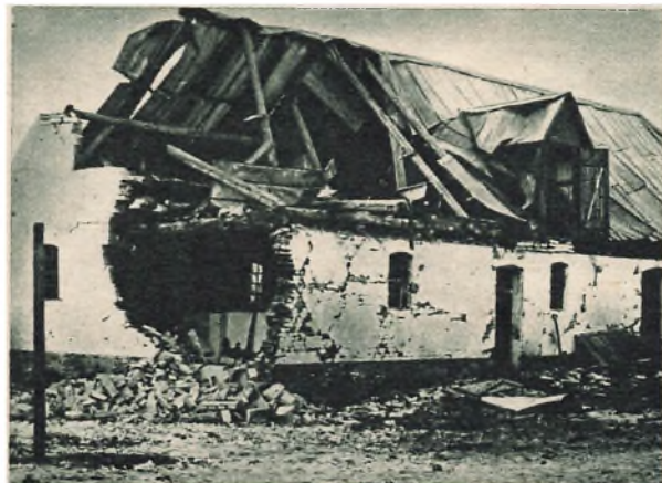
I Erstatninger for Bombeskader har Krigsforsikringen for Bygninger siden Krigsudbruddet udbetalt adskillige Mill. Kr.
