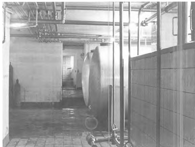
I kælderen langs Paabyvej, hvor de nye store tanke til valle blev bygget.
