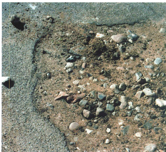
Her er der i 2008 gået hul på asfalten. Var det fordi asfaltlaget var for tyndt, eller var der ikke et tilstrækkeligt gruslag over skærverne? Når bilerne kører hen over hullet, presses skærverne op eller til siderne.
