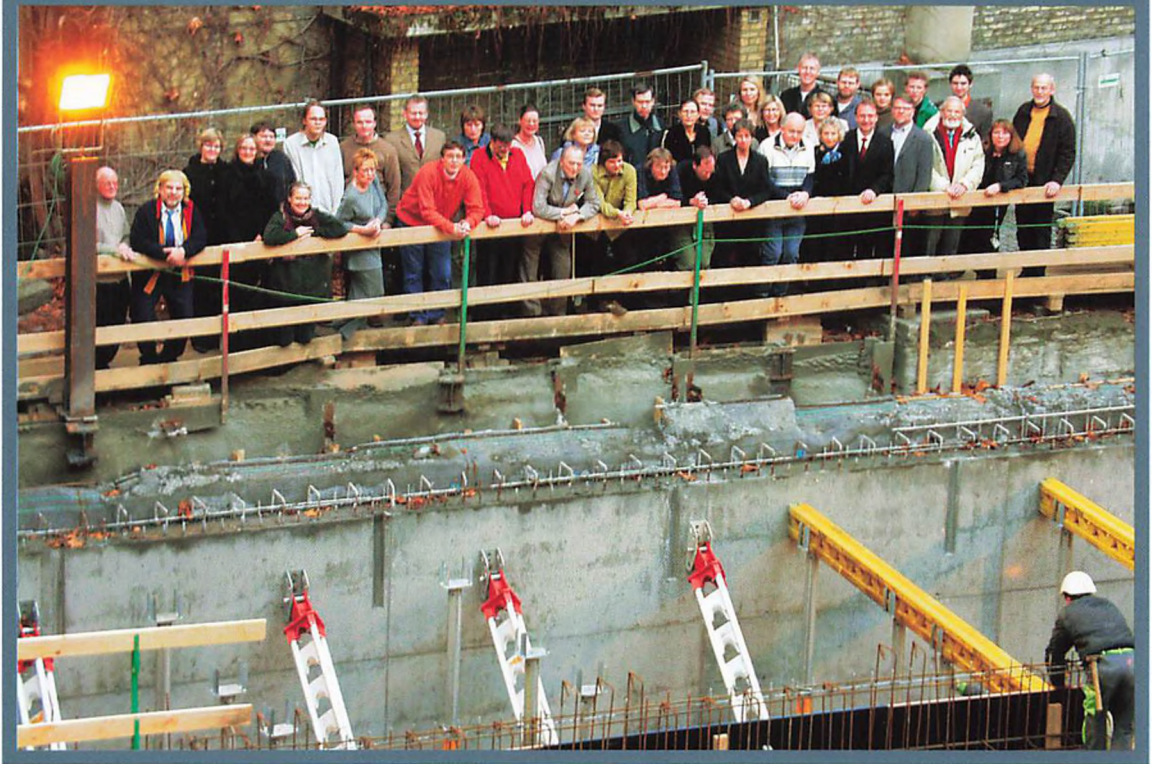
Personalet på Arbejdermuseet og Arbejderbevægelsens Bibliotek og Arkiv omkring juletid i 2003 ved udgravningen til den nye tilbygning. Foto: Allan Schnipper.
