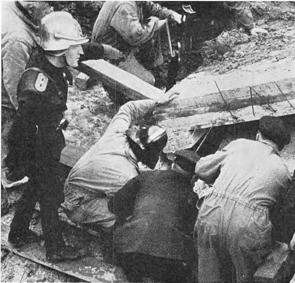
Pionerer i arbejde ved sammenstyrtningsulykke. Ved en ulykke på Prags Boulevard blev en arbejdsmand fastklemt under et nedstyrtet betonloft. Manden blev frigjort ved hjælp af donkrafte og betonbrækkere.
