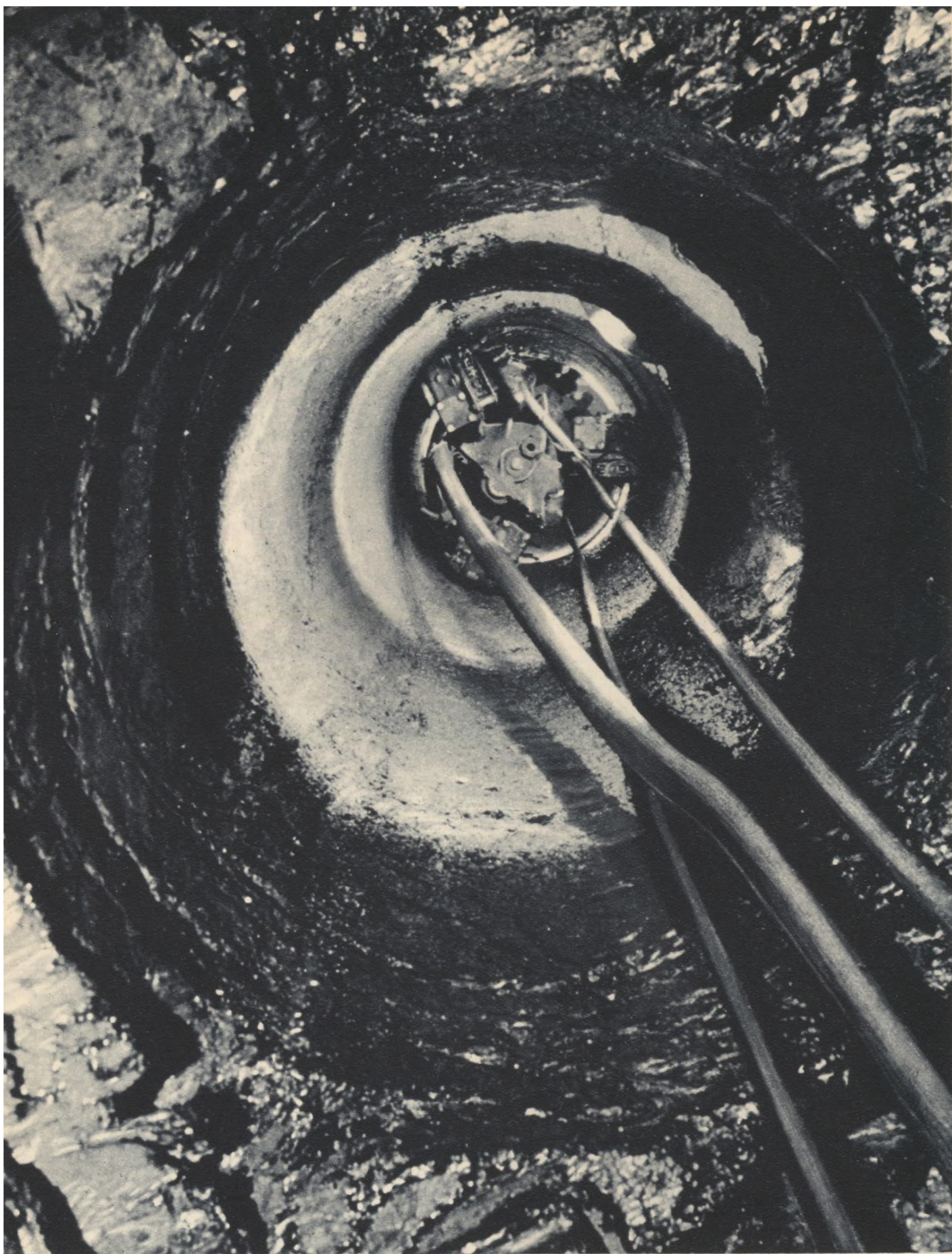
Die Vortriebsmaschine frißt sich ins Flöz ein, nur durch die Schläuche des pneumatischen Systems mit dem Arbeitsplatz des sie steuernden Maschinisten verbunden
