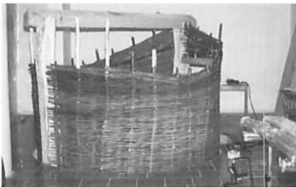
De tagbærende stolper og rygåsen er rejst og væggen vidjeflet får huset til at ligne en gigantisk kurv.
