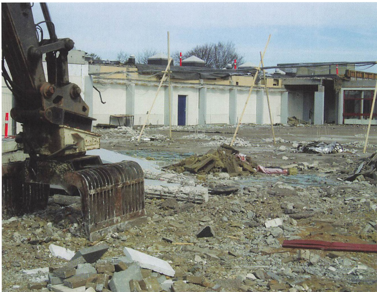
Ombygningen af Fredericia Gymnasium er i gang. I april 2007 blev den midterste del af gymnasiet ryddet, så den ny genopbygning kunne gå i gang (Fot. Fredericia Gymnasium).
