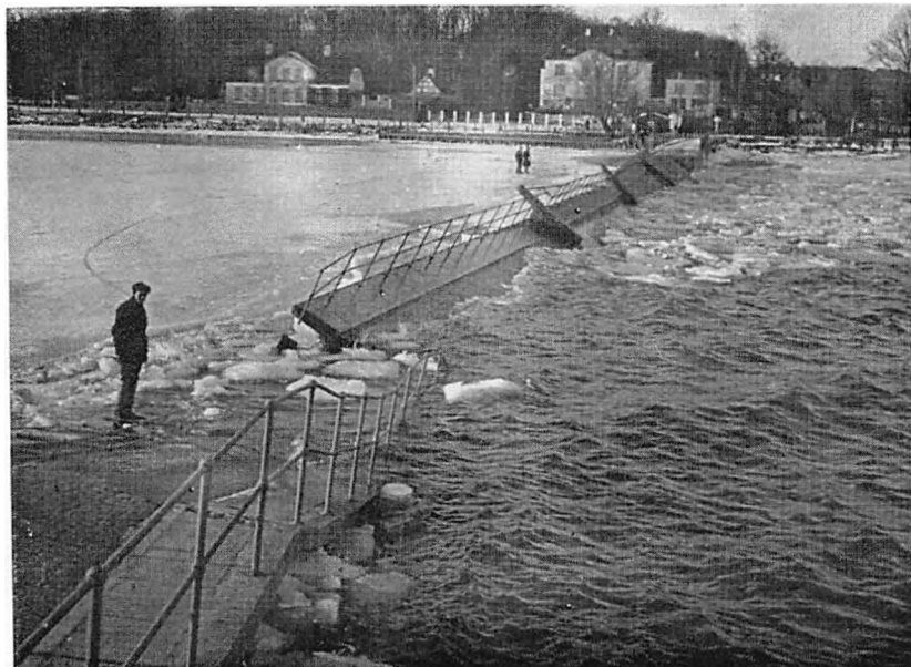
Den 27. januar 1924, kun syv måneder efter at havnen var indviet, blev betonbroen med tilkørselsvejen fuldstændig ødelagt af drivis. Huset til venstre er „Søholm“. Husene ud for broen tilhørte grosserer Henius. De blev revet ned i 1960'erne. Foto, 1924. Museet.
