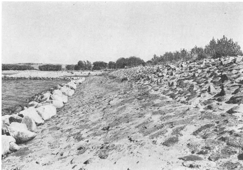
Dæmningens yderside. Nederst ses rækken af store sten, der tager trykket af bølgerne. Hele siden er beklædt med sten, der beskytter dæmningen. I den øverste del af stensætningen ses fremspringende sten.
