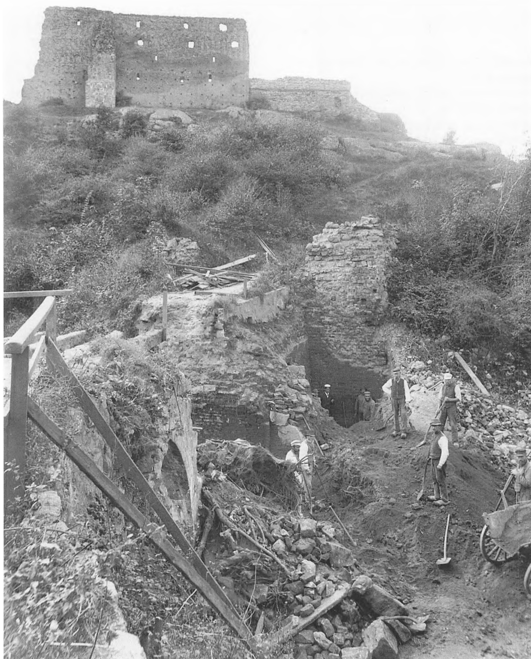
Fig. 2. Broens nordlige side under rydningsarbejdet og udgravningen. P. Hauberg fik kørt adskillige læs jord væk fra borgområdet; det var affald og murbrokker, som havde lagt sig højt op af bygningerne i tidens løb. Foto: Nationalmuseet.
