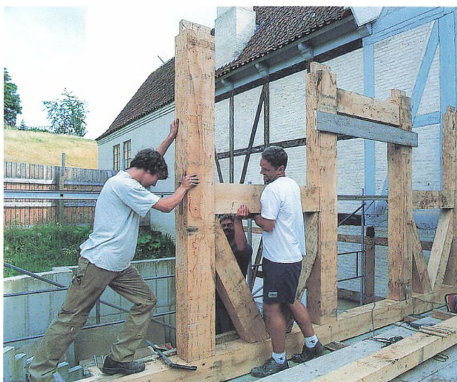
Fem-fagshuset under opførelse. På billedet ses fra venstre mod højre tømrersvend Simon B. Kjær, tømrersvend Ejvind Maltesen og tømrersvend Gert Rasmussen. Foto Knud Nielsen.
