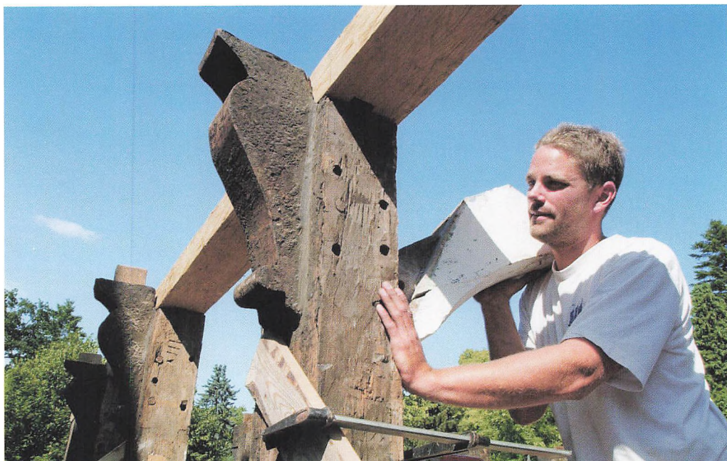
Tømrersvend Simon Kjær under arbejdet med at genrejse bindingsværket til fem-fags-huset fra Aalborg. Foto Århus Stiftstidende.
