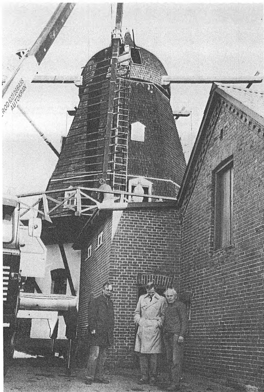
Borgmester H. E. Nielsen ser på skaden og lover udbedring. (Foto: Bente Thines Hansen)
