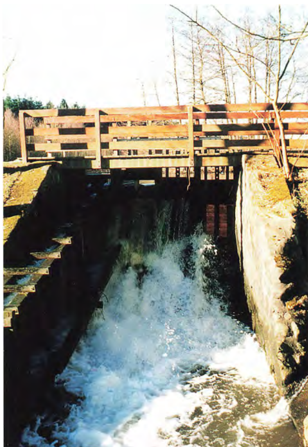
Fisketrappe og bagsluse ved Børkop Vandmølle
