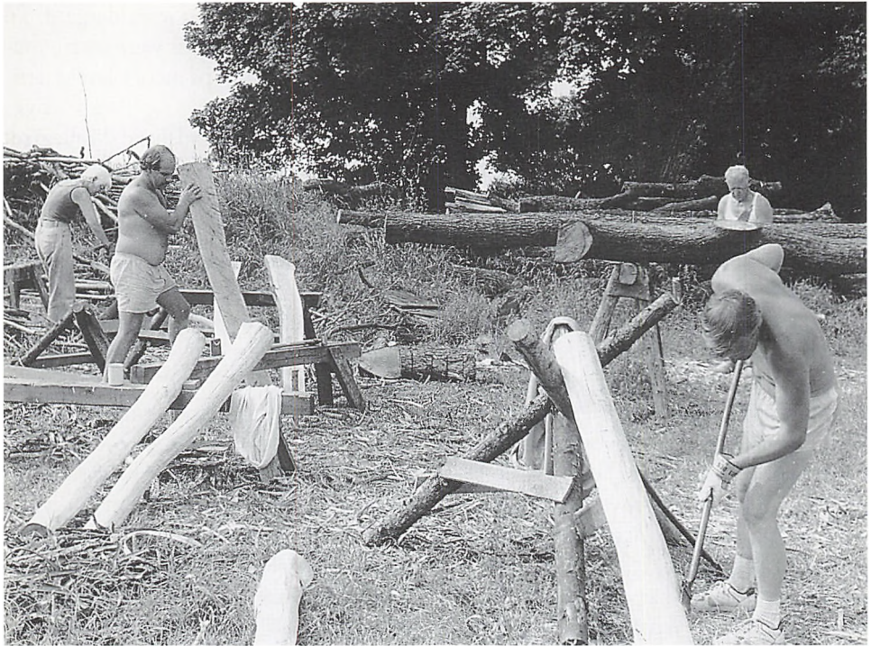
Huggepladsen, hvor egetømmeret tildannes. Træet er det lykkedes at skaffe lokalt fra Dejbjerg Plantage.
