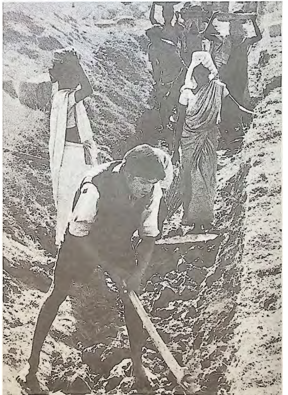
39 familier kan med et vandingsanlæg få ændret deres dagligdag fundamentalt. De er rede til selv at udføre en del af arbejdet.
