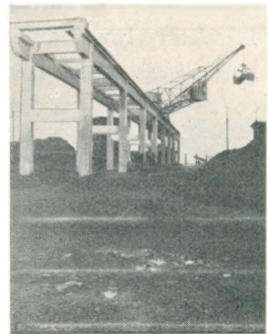
Firmaets nye Krananlæg.
