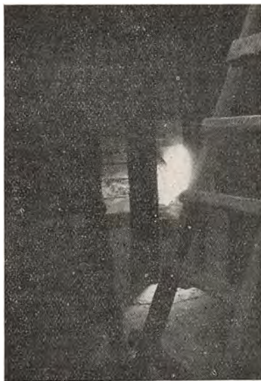
Et af Hullerne i Spiret - set indefra. Projektilet er her slaaet gennem Kobberet og Forskalningen og har knust en af de svære Bjælker, der danner Spirets Skelet.
