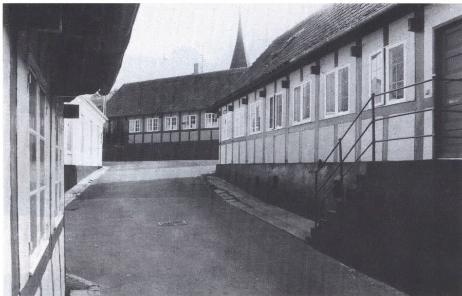
De allerfleste bornholmske huse har – uanset alder – gennemstukne bjælker som hér i Svaneke.
