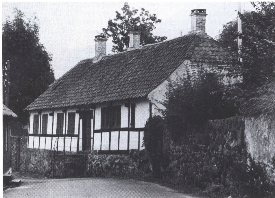
I dag er tavlene på de bornholmske gårde og huse for det meste udmurede med tegl som her på et nordøst-bornholmsk hus, men forhen var det lige så ofte lerklinede tavl eller tavl med isatte sandstensplader, man traf. Den stærke skrånen på terrænet og den høje kampestenssokkel kræver også en høj trappe.
