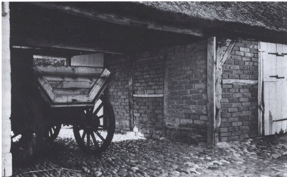
Den typiske vestjydske lerfugning mellem hjemmebrændte mursten, som fremtræder i relief, fordi leret er udvasket til en vis dybde. Bygning fra Husby, nu på Hjerl Hede.
