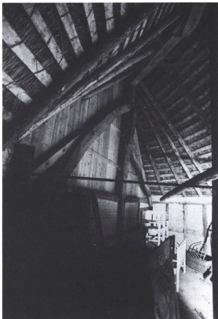
Trund-konstruktionen på Grimstrup-gården set indefra. Man ser åsbjælken, der ligger over en anden åsbjælke forlængel ud over sulen samt hvordan forbindelsesbjælken hviler på sulen i det næste hus. Der er hængeltræer ud til hvert af hjørnets knækkende fag.
