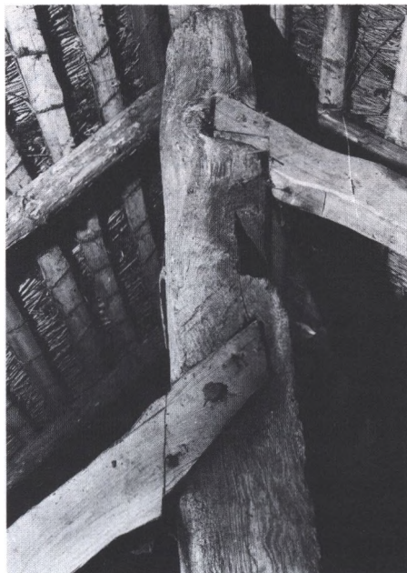
Samlinger mellem skråstivere og sule. Stiverne er skåret ind i sulens side og naglet fast til den med trænagler. – Sulegården Grimstrup.
