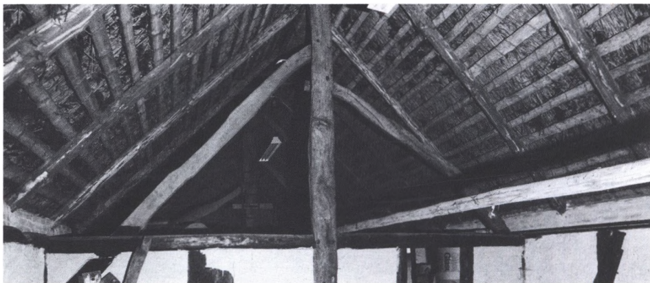
Den ældste sulekonstruktion med meget lange skråstivere, der går ud til ydervæggene. Bemærk at sulen står i en væg, som giver den støtte. – Sulegården i Grimstrup ved Assens.
