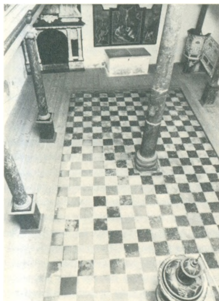
Gulvet i Sønderborg slotskapel, som det ser ud i dag. Sammenlign med farvebilledet s. 60.
