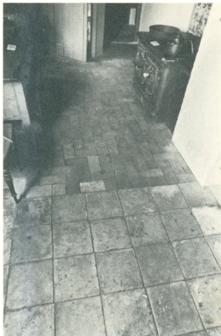
Køkkengulv på Frilandsmuseet i Sorgenfri, hvor man bryder mellem almindelige teglsten lagt i opus spicatum bagest og i forgrunden teglstensfliser. Sådanne var meget brugt ikke mindst i det slesvigske område, hvor man også havde dem grøngluserede eller helt sortagtige.
