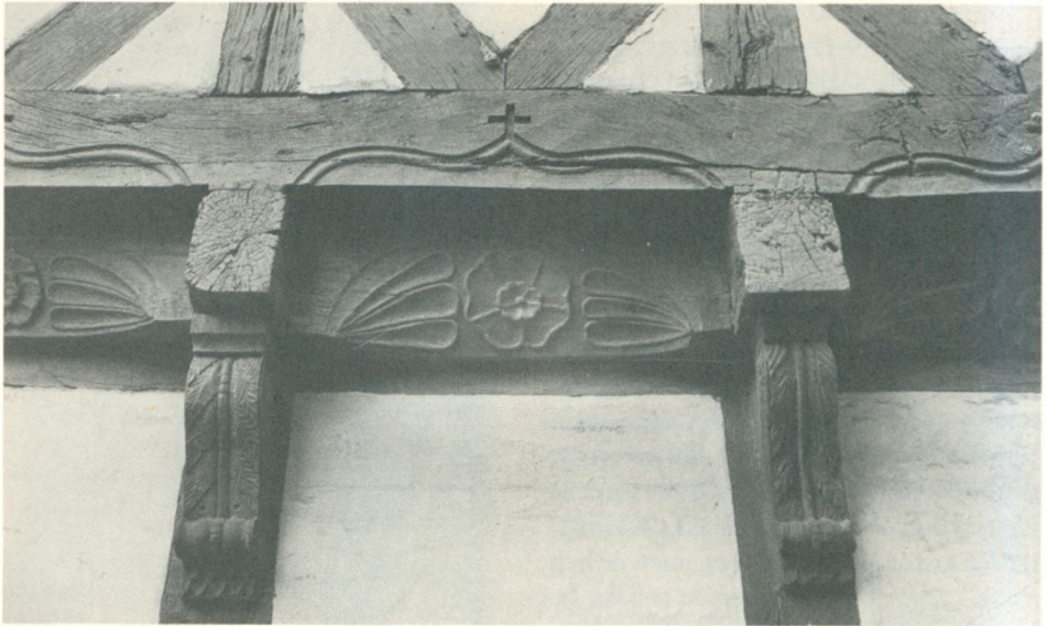
Volutknægte fra renæssancen med velskåret, måske lidt stift akantusværk og perlestaf i midten. Mellem bjælkeenderne er der et fyldholt og derover en æselrygbue med kors. Stengade, Helsingør.
