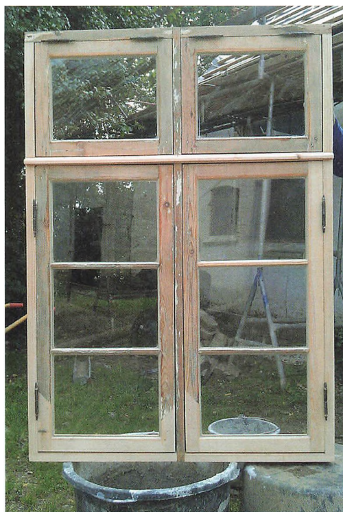
Alle vinduer er afrenset, eftergået for råd og partielt udbedret med sundt træ. 2011 (Jørgen Overbys Tegnestue A/S)
