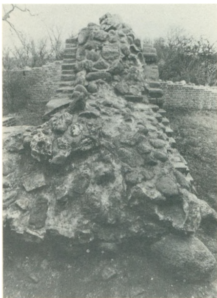
Kassemur i Kalø slotsruin. Strykket udfyldt med marksten i mørtel kaldes murlivet, og deri kunne der nok blive plads til smalle trapper.
