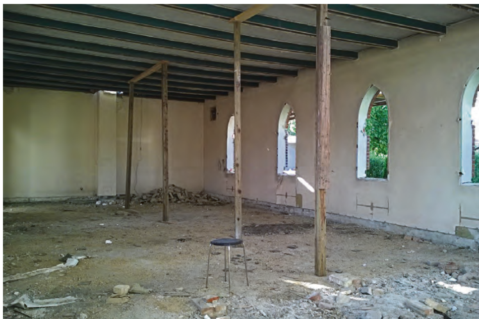
Sankt Clemens Kirke i Grenå. Alt inventar er fjernet og bygningen er klar til nedrivning.
