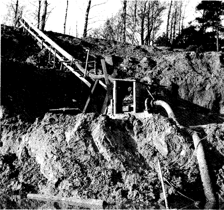
Fig. 33. Pumpeledningen. Foto: Kaare Rasmussen. (Bornholms Museum.)
