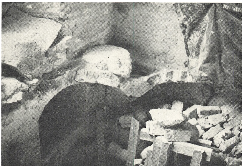
Kælderhvælv i nordvesthjørnet under reparation. Enkelte hvælv måtte tages ned og opmures påny.
