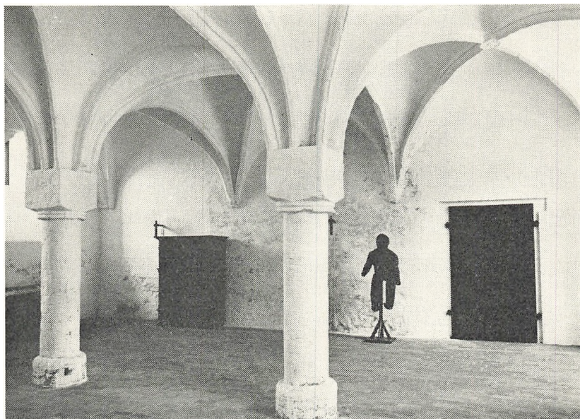
Drabantsalen i vestfløjen med ribbehvælv, båret af to murede søjler. Efter restaurering.
