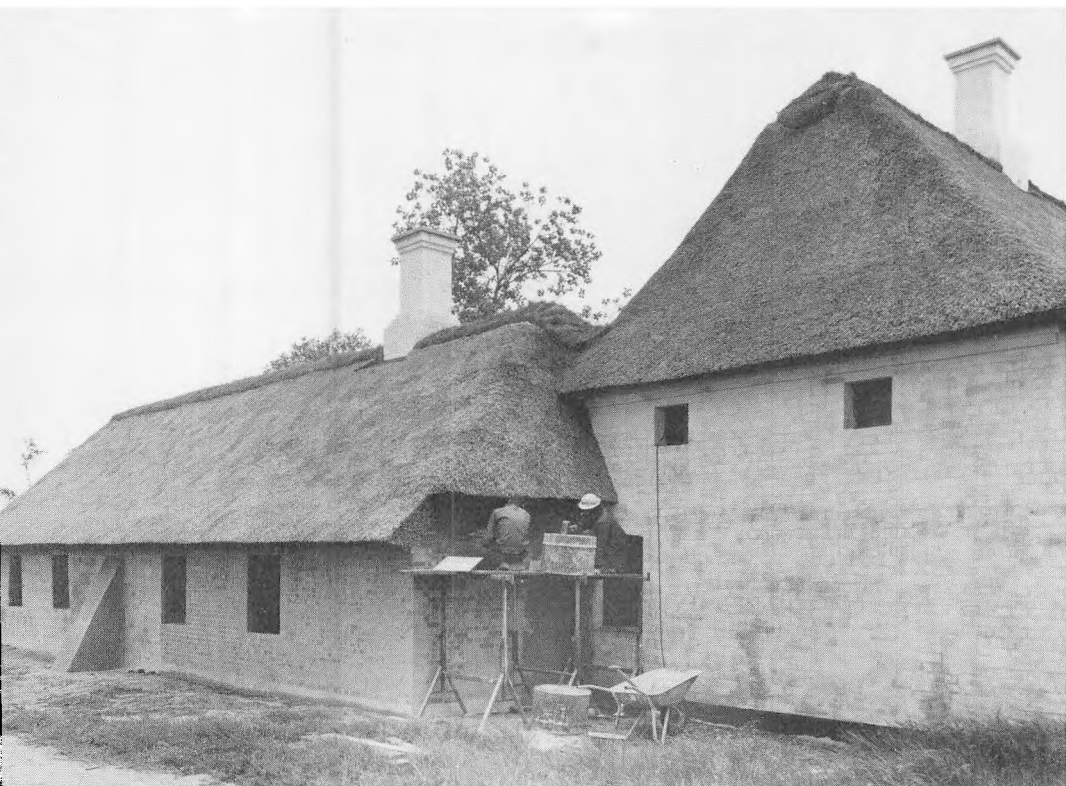
Nygaard skole sommeren 1983. Meget er allerede restaureret, på billedet ses de to bygningsarbejdere Joen Peter Madsen og Nayim Caban i færd med at pudse gavlen på gymnastiksalen. (Kjeld Hansen fot. Herning Museum).
