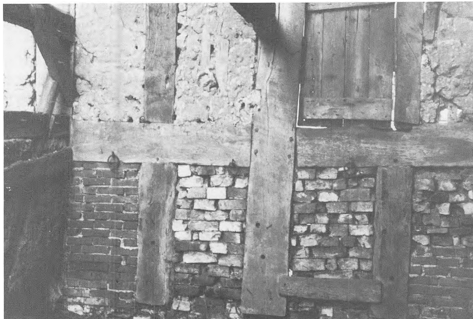
Virring præstegårdslade. Indvendig udsnit. Bemærk jernringene i løsholterne og det manglende fodtømmer. 1971.
