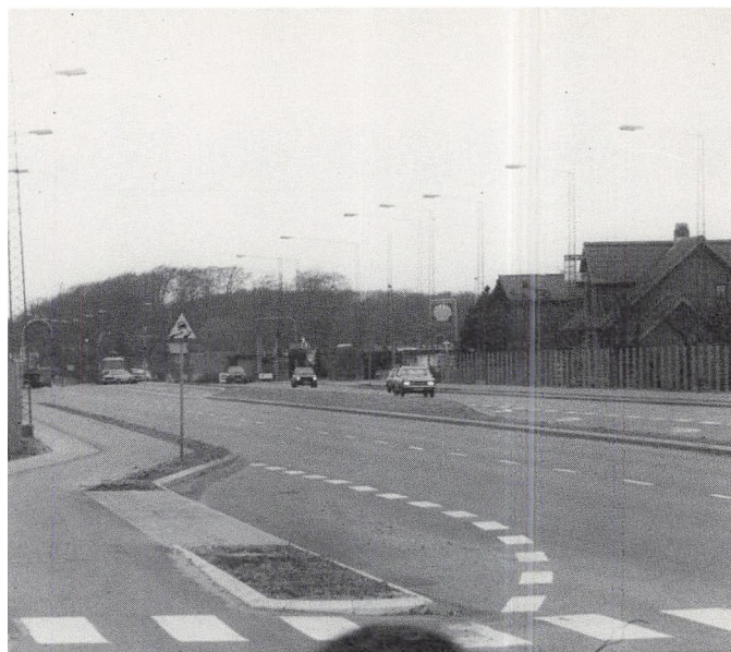
Grenåvej ved krydset Tranekærvej, marts 1983. På begge sider af vejen ses de såkaldte standardskærme, der har en vis støjdæmpende virkning, under rejsning. De lodretstående stolper er placeret, men træbeklædningen og den eventuelle beplantning mangler.
