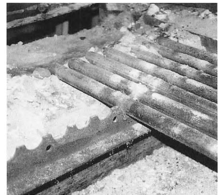
Varmerør placeret i T-jern med buer.
