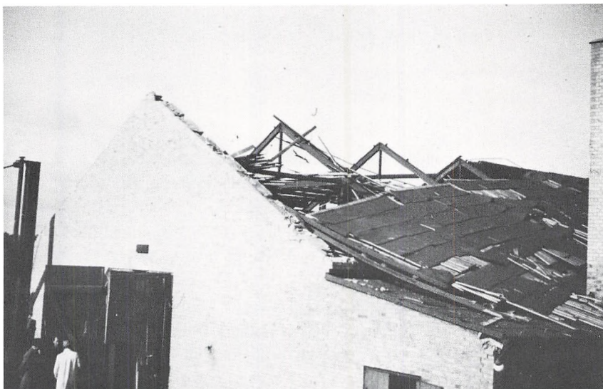
Maskinfabrikken »Iron« på Buddingevej 343 oplevede d. 2. marts 1943 Glad-saxe Kommunes første sabotage, hvor en BOPA-gruppe gik i aktion. Fabrikken lavede skibspumper til tyskerne. Her ses de omfattende skader.
