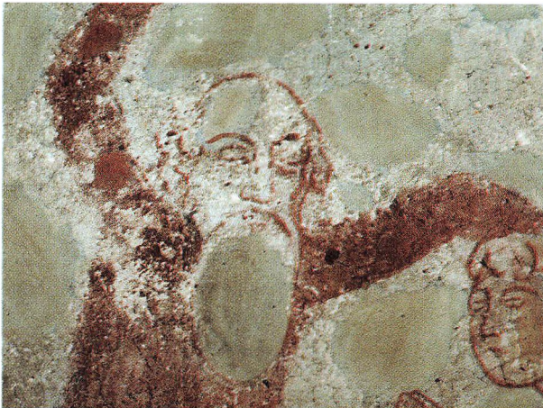
Fig. 1: Korets nordvæg, "Isaks Oftring" før restaurering: Salte er udkrystalliseret og har lavet skader i overfladen af originalmaleriet omkring de gamle, hårde reparationer. Foto: Isabelle Brajer.
