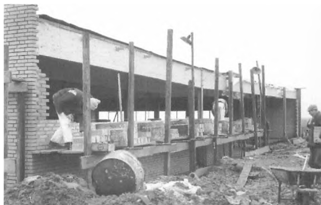
Figur 7: 30. januar 1969 var byggeriet nået så langt, at murerarbejdet var vidt fremskredet. (Foto udlånt af SuperBrugsen. Fotograf formentlig Henry Rasmussen).
