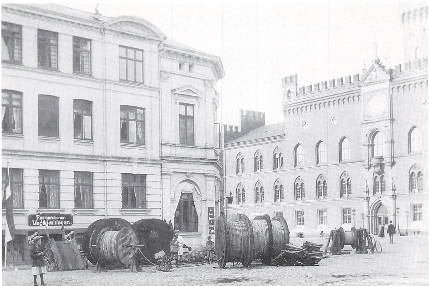
Nedlægning af kabler ved Flakshaven i forbindelse med opførelsen af det kommunale elværk på Klosterbakken i 1908 (R.Frehse fot., Møntergården).
