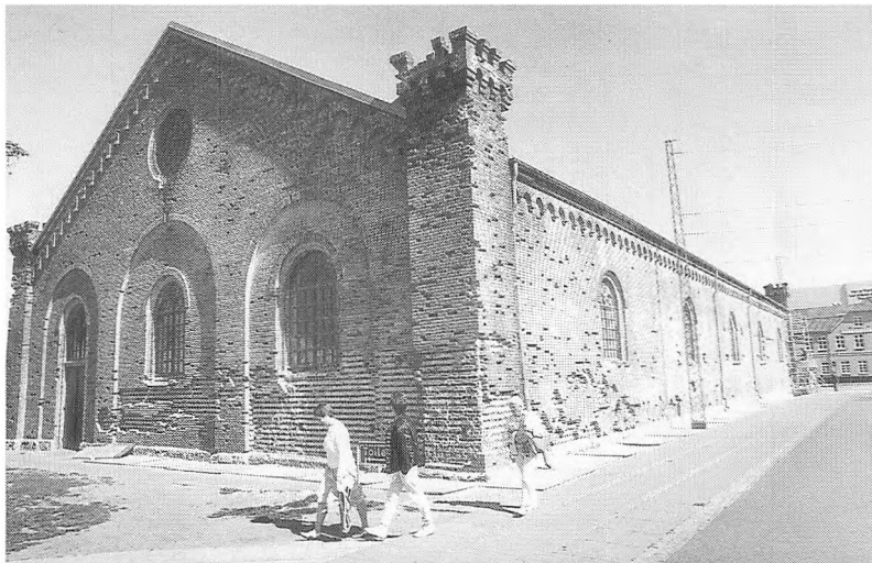
En hel del mursten i Ridehusets mure er ved at blive udskiftet, da de efterhånden var krakeleret så meget, at de truede med at ødelægge resten af muren. (Foto: Axel Schütt).
